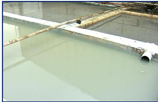
Şekil - 90. Asitli Suyun Arıtımı
