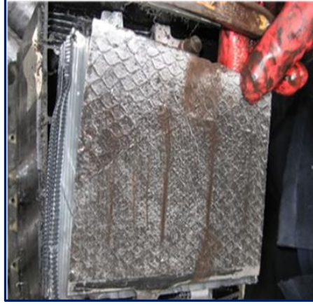
Şekil - 13. Sülfatlaşma Meydana Gelmiş Plaka
